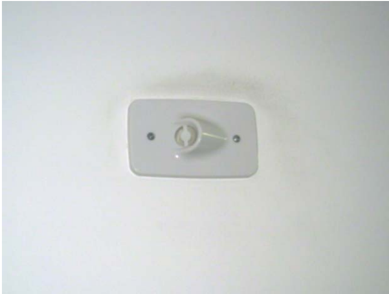
Alarma de Incendio
